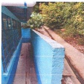
Foto 7: Suministro e instalación de barandas en muro perimetral (se hace la observación de que en esta área el alumno corre peligro de subir y caer de muy alto y golpearse)
