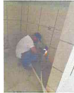
Foto 8: SUSTITUCION DE MINGITORIO (los mingitorios no funcionan son demasiado antiguos y es un pestilencia que se acumula, por tal razon la opf decidíó cambiarlos, el precio incluye revision de tuberías).
