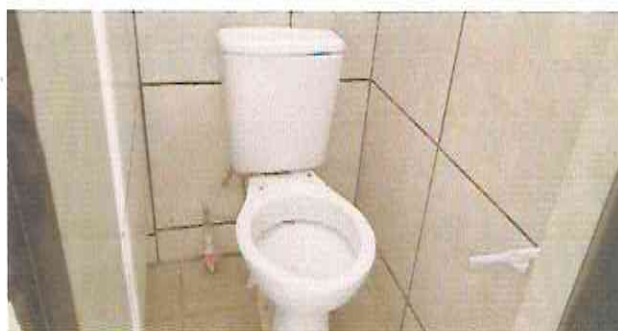
Foto 6: SUSTITUCIÓN DE INODOROS AMERICAN STAR (los 9 sanitarios estan en malas condiciones, en varias veces se han remozado y no funcionan, y la opf decidió cambiarlos por unos de alta calidad)
