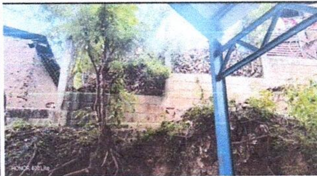
Proteccion de muro existente, ya que se encuentra en riesgo de desbanecerse, pone en riesgo la vida de los estudiantes y al moento de la lluvia pueda colapsar.
