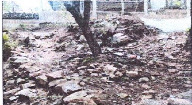
Foto 2: Proteccion de muro existente con, siendo necesario, ya que es inseguro para los estudiantes debido que se encuentra en el ingreso del establecimiento educativo
