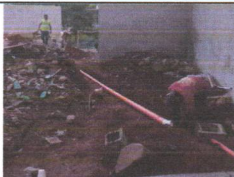
foto 5. Drenaje 5.1 Instalacion de tubería para drenaje el que esta presta deteriorado
