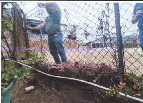
Foto 1: muro que necesita cambio de malla ya que se encuentra dañado.
