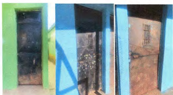
Foto 3: Modulo de aulas: Sustitución de tres puertas de metal por que se encuentran en mal estado y deterioradas
