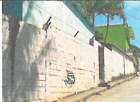
Foto 8: Pintura en muro parte exterior
