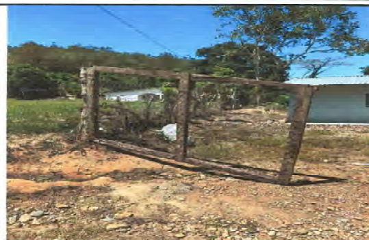
FOTO 1.2 SUSTITUCIÓN DE PUERTA DE MADERA Y TELA MALLA POR PUERTA DE TUBO GALVANIZADO HG Y TELA MALLA DE 2.5X2.5
