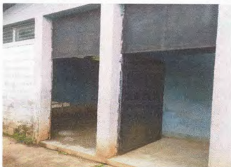
Foto 7: INGRESO A BAÑOS, DESPROVISTOS DE PINTURA, SIN PISOS LAVABLES
