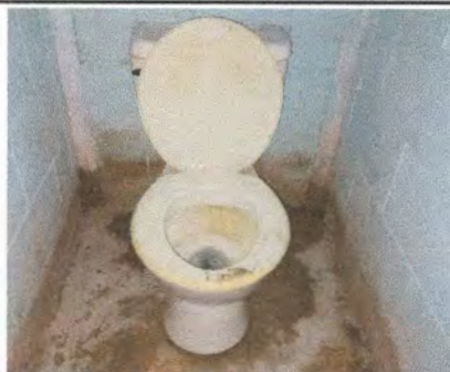
Foto 11: CONDICIONES DE SANITARIOS EN MAL ESTADO
