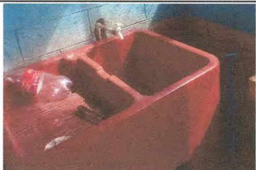
Foto 3: PILA DE LA COCINA, SERA REUBICADA CON SU DRENAJE Y SERVICIO DE AGUA.
