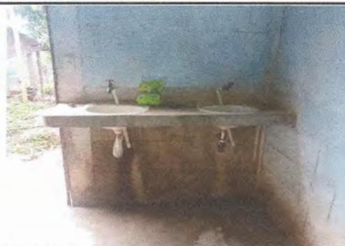
Foto 10: LAVAMANOS EN LOS BAÑOS EN MAL ESTADO.
