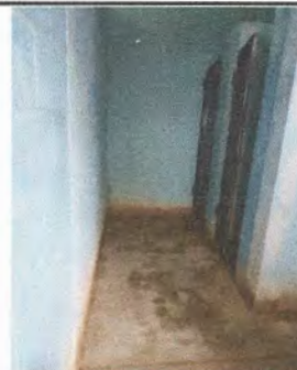
Foto 12: PINTURA DETERIORADA EN INTERIORES DE BAÑOS
