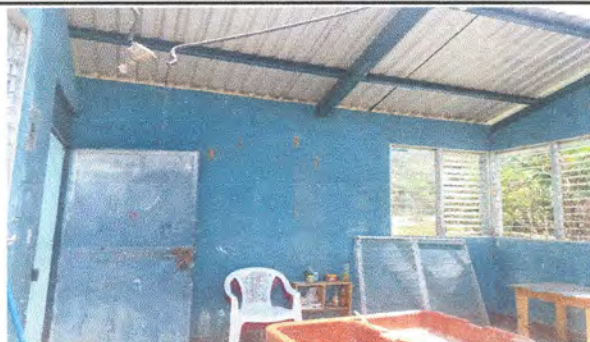
Foto 4: PINTURA DETERIORADA EN MUROS Y PUERTA DE ACCESO.
