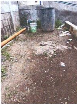
Foto 13: Sustrucción a losa de patio
