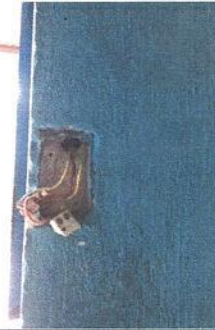
Foto 12: Sustrucción de apagador
