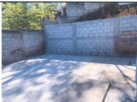
Foto 11: Sustitución de Muro de Block. El muro presenta deterioro severo por humedad manchas oscuras y estructura adosa dañada, por prioridad de los e estudiantes es necesario sustituirlo.
