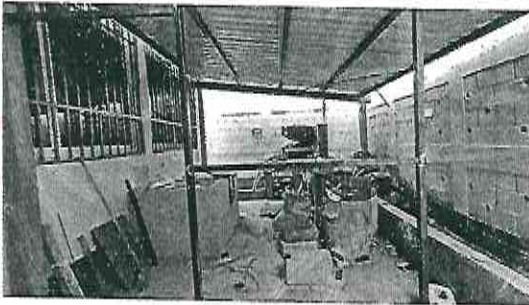
Foto 3: CIRCULACIÓN DE COCINA CON MALLA Y TUBO PROCESO
