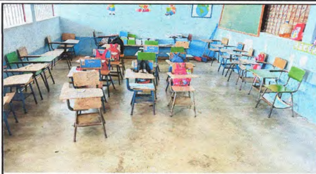
Foto1: AULA QUE REQUIERE DE UN NUEVO PISO
