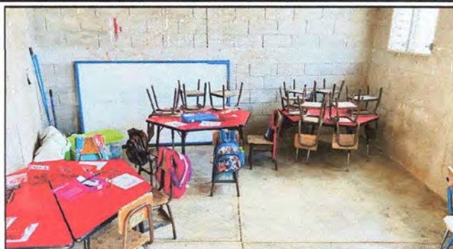
Foto 2: AULA QUE REQUIERE DE UN NUEVO PISO
