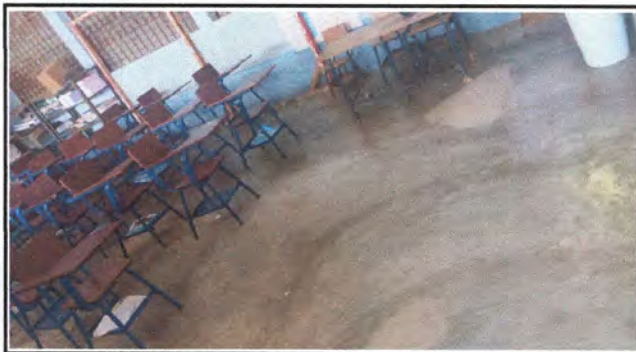
Foto 3: AULA QUE REQUIERE DE UN NUEVO PISO
