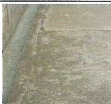
Foto 8: Sustitución de Planchas de Concreto en Mal Estado en Patio (Presentan Grietas)
