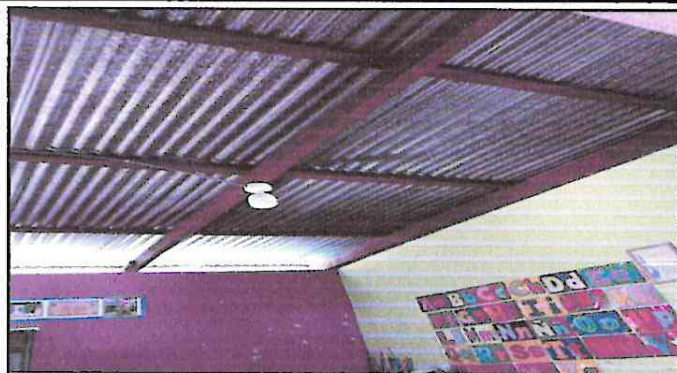
Foto1: TECHO DE AULA QUE REQUIERE SUSTITUCION
