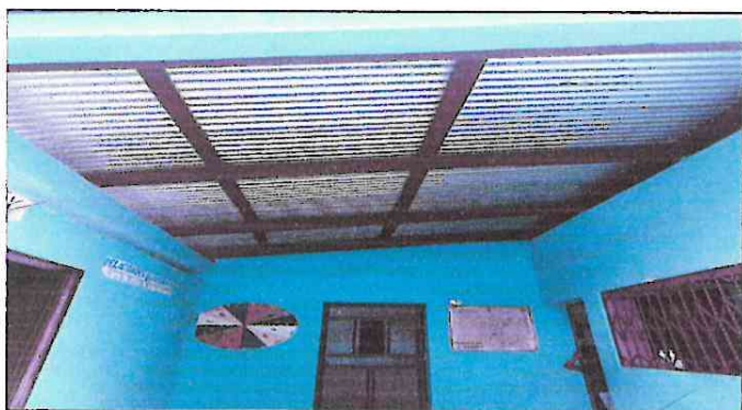
Foto 3: TECHO DE AULA QUE REQUIERE SUSTITUCION
