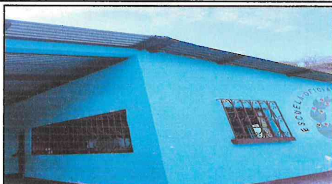
Foto 2: TECHO DE AULA QUE REQUIERE SUSTITUCION
