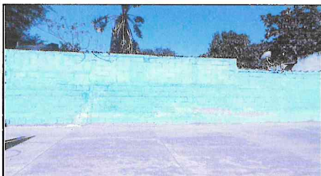
Foto 7: MURO PERIMETRAL QUE REQUIERE REPELLO Y CERNIDO, PINTURA
