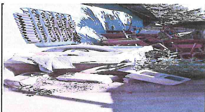
Foto 9: ÁREA DE PATIO QUE REQUIERE PISO DE CONCRETO
