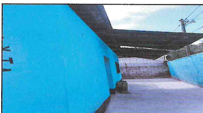
Foto 4: TECHO DE AULA QUE REQUIERE SUSTITUCION
