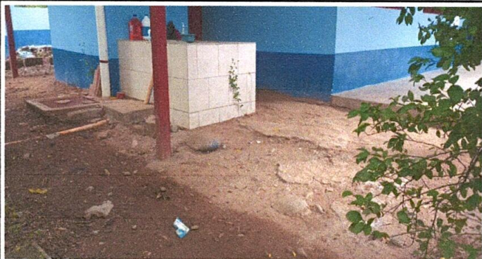
Foto 13: Planchas de concreto en patio.
