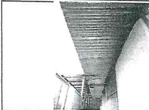
Foto 1: Sustrucción de Lámina y Estructura de Soporte de Metal en Cocina
