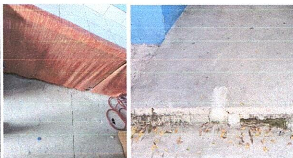
Foto 2: COCINA-REQUIERE INSTALACIÓN DE PISO.
