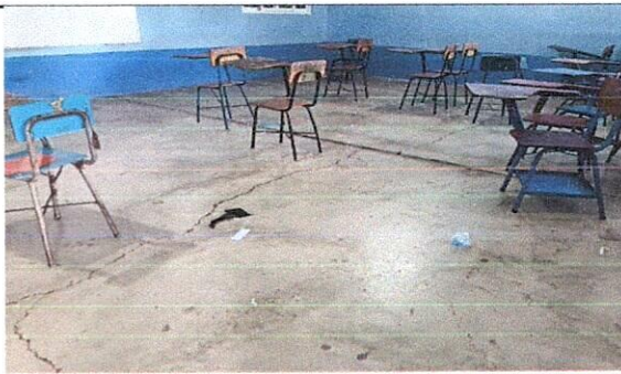
Foto 4: AULA 3 QUE REQUIERE DE UN NUEVO PISO
