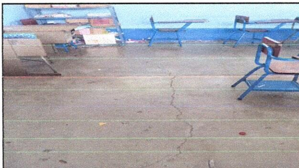
Foto 3: AULA 2 QUE REQUIERE DE UN NUEVO PISO
