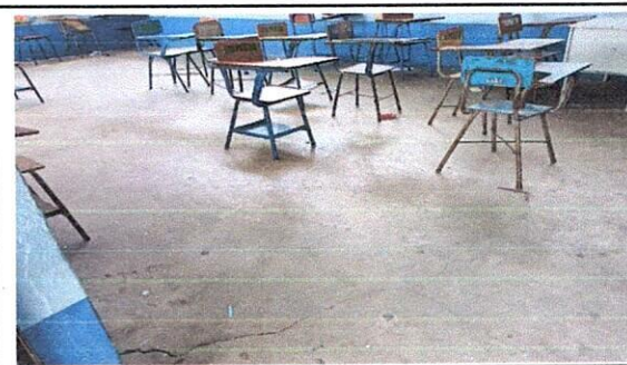
Foto 6: AULA 3 QUE REQUIERE DE UN NUEVO PISO
