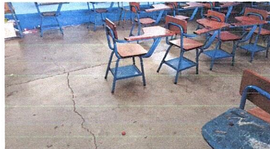
Foto 2: AULA 1 QUE REQUIERE DE UN NUEVO PISO
