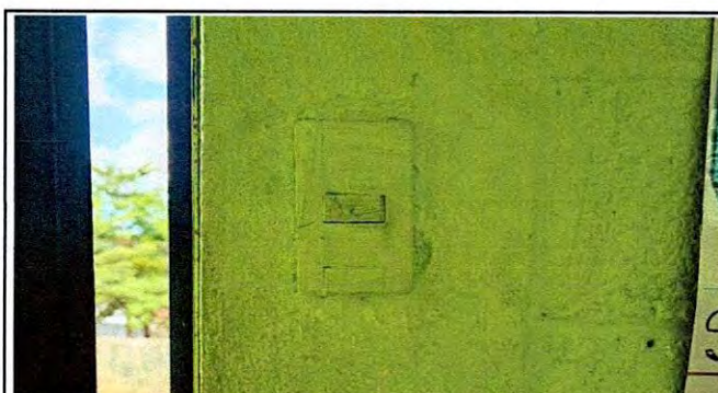
Foto 4: REFERENCIA DE ACCESORIOS ELÉCTRICOS EN MAL ESTADO. Aula 1
