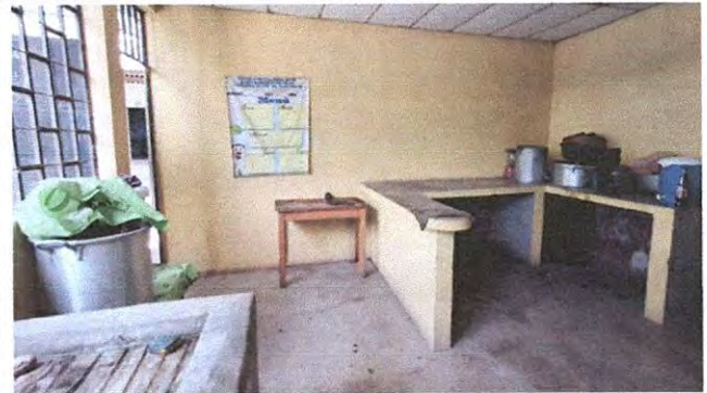
5.2. Mantenimiento a la puerta de la cocina q se encuentra en mal estado.
