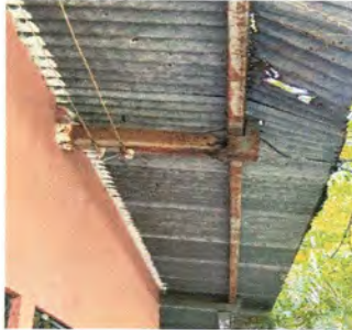
Foto1: SUSTITUCIÓN DE ESTRUCTURA METÁLICA EN MAL ESTADO MODULO #2
