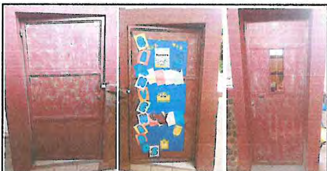
REPARACION Y MANTENIMIENTO A PUERTAS DE METAL EN AREA DE AULAS (LIJADO Y PINTADO) 1 X 2 M2 (UNAS ESTAN PODRIDAS DE ABAJO Y OTRAS NO CIERRAN PORQUE SON MAS GRANDES)
