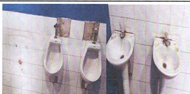
Foto 3: Los mingitorios y los lavamanos necesitan reparación por deterioro y el azulejo también está dañado.
