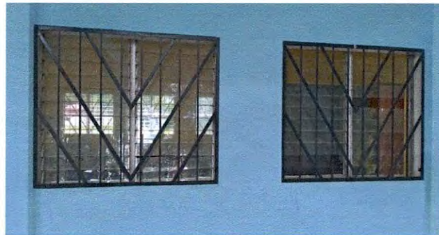
Foto 2: Las ventanas tienen vidrios rotos y se desea reemplazarlos por ventanas PVC para un ambiente más agradable.
