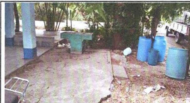
Foto 4: El patio necesita una reparación en la losa que se encuentra en la entrada secundaria del instituto.
