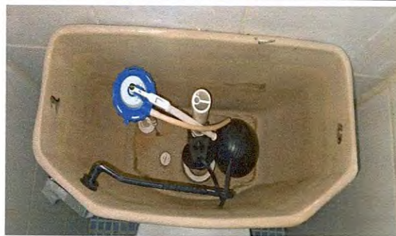
Foto 4: El baño necesita cambio de los accesorios para evitar fugas de agua.
