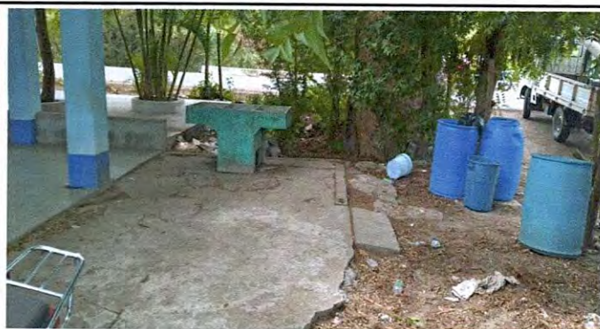
Foto 9: El patio necesita una reparación en la losa que se encuentra en la entrada secundaria del instituto.
