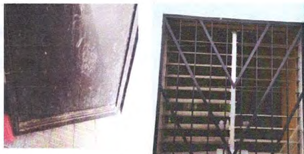
Foto 1: Las puertas presentan signos de deterioro y algunas cierran con dificultad, las ventanas están parcialmente quebradas.
