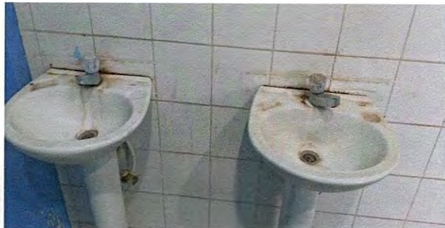
Foto7: Las llaves de los lavamanos están en mal estado por lo que se desea reemplazar las llaves y así optimizar el uso del agua.
