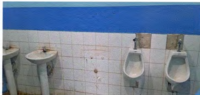
Foto 8: Los azulejos colocados en los baños están dañados y se desea cambiarlos por nuevos.
