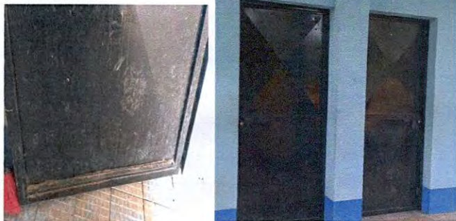
Foto 1: Las puertas presentan signos de deterioro y algunas cierran con dificultad, por lo que se va sustituir chapa y algunos materiales como tuvos dañados por la corrosión.
