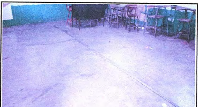
Foto 4: Se observan los Hundimientos en los Niveles del Piso en Aulas
