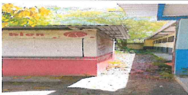
Foto 7: Introducción de agua servidas en cocina
