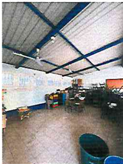
Foto 5: Ventiladores en aula numero 2.
