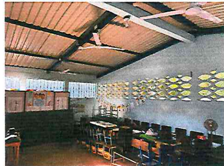
Foto 4: Ventiladores en aula numero 1.
