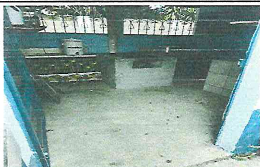
Foto 5: Se requiere la instalacion de piso ceramico antideslizante en cocina para mejorar las condiciones del area.
