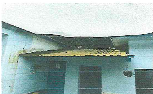
Foto 3: Estado actual de cubierta de lamina la cual se pretende darle mantenimiento, la lamina esta en buen estado como se observa en la Foto 4 y 6, unicamente se le hara una limpieza y aplicar pintura anticorrosiva y
