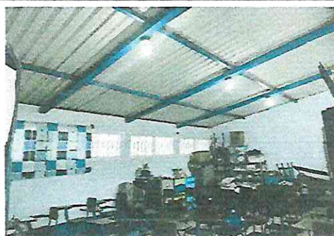
Foto 4: Se requiere la instalacion de ventiladores de techo para mitigar las altas temperaturas del area y la ventilacion de los salones.
