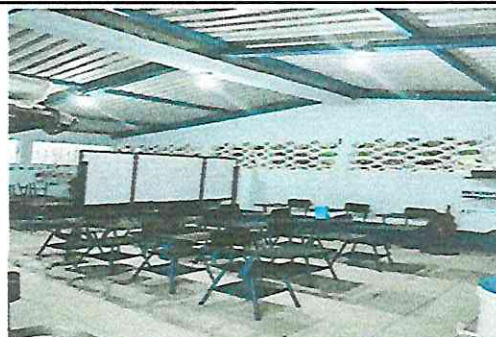
Foto 6: Se requiere la instalacion de ventiladores de techo para mitigar las altas temperaturas del area y la ventilacion de los salones.
