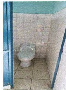
Sustitución de sanitario, esta tapado y no está en uso.
