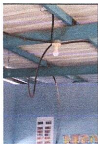
2.6 Sustitución de caja de flipones
