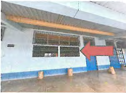
Foto 15: Balcones en mal estado a reparar 77 x 1.57 mts
