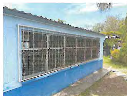
Foto 2: Balcones en mal estado a reparar 5.14 x 1.35 mts
