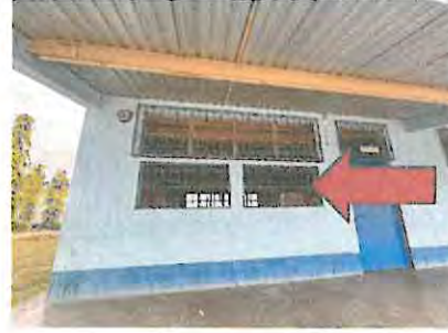
Foto 14: Puertas de baños a dar mantenimiento 78 x 1.52 mts
