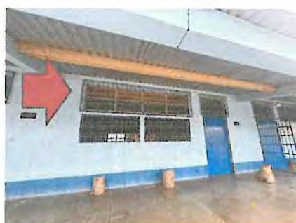
Foto 12: Balcones en mal estado a reparar 96 x 3.5 mts
