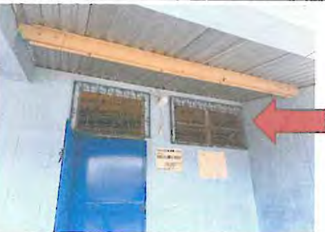
Foto 17: Balcones en mal estado a reparar 95 x 1.70 mts
