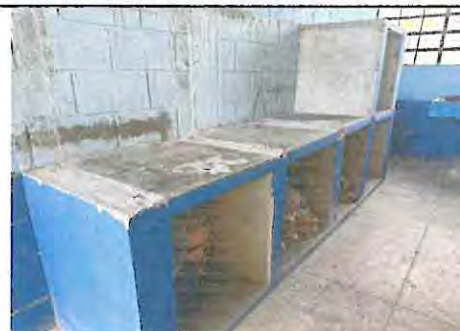
Foto 6: Espacio y estantes de cocina a reparar e instalar azulejo
