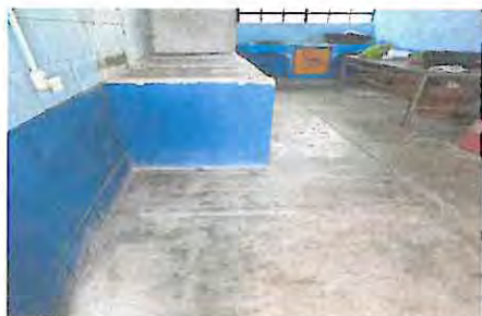
Foto 7: area de cocina a reparar piso
