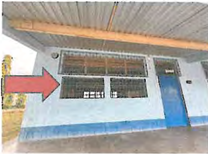
Foto 13: Balcones en mal estado a reparar 78 x 148 mts
