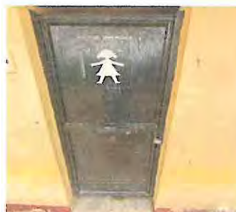
Foto 8: Puertas de baños a dar mantenimiento
