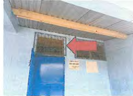
Foto 16: Balcones en mal estado a reparar 86 x 1.27 mts
