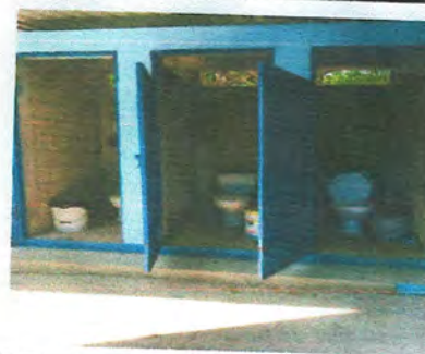
Foto 6: Repello ,cernido y pintura en paredes
