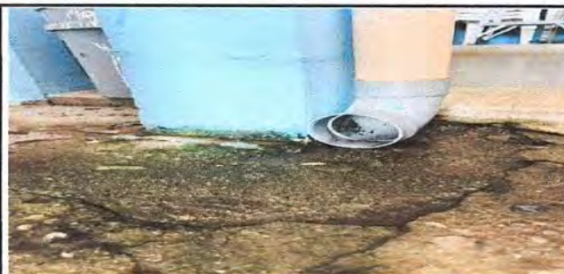
Foto 4: 2. Patio 2.1 sustitución de línea de drenaje de agua pluvial, el patio se mantiene mojado cada vez que llueve.
