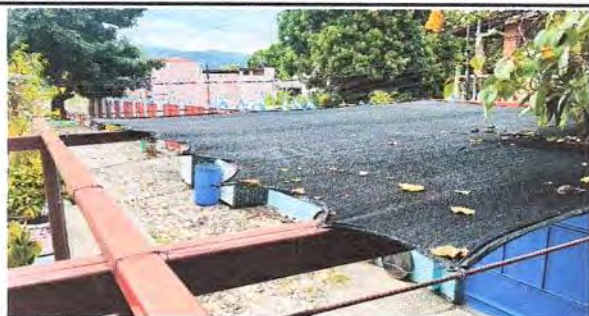
Foto 3: 1. Entrada principal. Este es el techo existente, está con sarán, se filtra el agua, se sustituye por lámina troquelada y se continúa el techo para poder cubrir toda el área que se utiliza para formar a las alumnas para entregarla a la hora de la salida.
