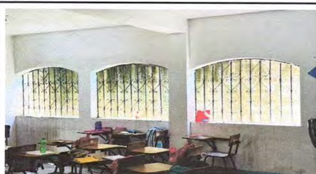
Foto 6: 3. Aulas 3.5 Suministro de instalación de ventanas de pvc. Las ventanas estan abiertas y cuando llueve se entra el agua y se moja el salon de clase.
