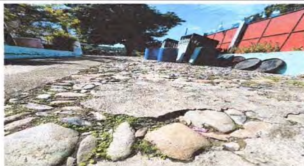
Foto 2: 1. Entrada Principal. 1.5 Fundición de losa entrada principal que se encuentra en mal estado y se caen las alumnas.
