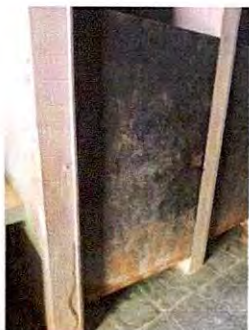
Foto 1: Necesario mantenimiento a estructura de puertas de sanitarios
