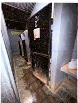
Foto 3: Estado actual de pintura de servicios sanitarios
