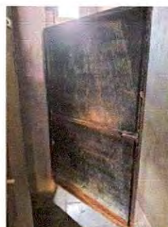
Foto 2: Necesario mantenimiento a estructura de puertas de sanitarios
