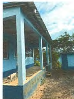
Foto 2: El exterior del aula en la parte del corredor se ve la pintura en mal estado debido a la exposición a sol y lluvia, la banqueta propuesta ayudara a evitar que se ensucie con tanta facilidad.
