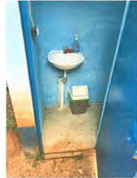
Foto 8. Estado actual de sanitario, es necesaria la instalacion de piso ceramico y azulejo para mejorar las condiciones sanitarias.
