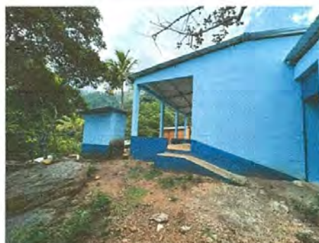
Foto 4. Necesaria la baqueta para facilitar el transito de los alumnos en los alrededores del establecimiento y así tambien proteger la infraestructura del mismo. Ademas se propone la instalacion de baranda en rampa de acceso.
