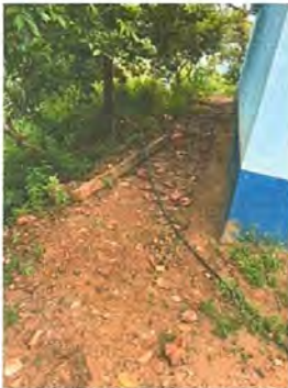
Foto 9. Actualmente el agua se lleva al establecimiento por medio de manguera de riego, por lo mismo es necesario la instalacion de tubería para mejorar las condiciones.
