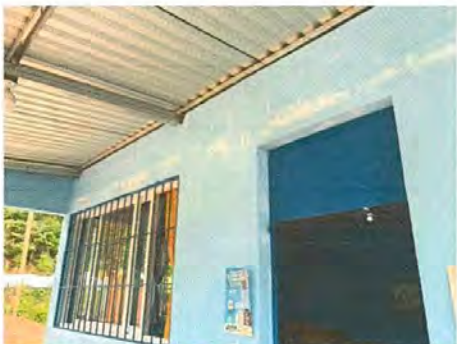
Foto1: Exterior de aulas en donde se propone pintura, en la parte alta se puede observar el mal estado de la pintura así como lo que parece un hongo lo cual representa un riesgo para la salud de los alumnos.
