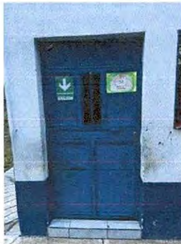
Foto 3: Estado actual de puertas que se propone el mantenimiento de las mismas.
