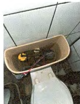
Foto 5: Estado de accesorios de tanque en servicios sanitarios.
