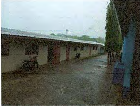
Foto 7: Necesidad de instalacion de canales para encauce de aguas llovedizas
