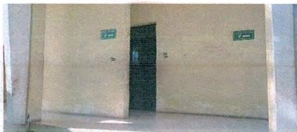
Foto 2: Pintura de muros interiores y exteriores ( pintura aplicada hace 10 años).
