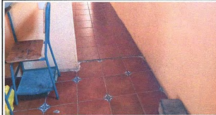
Foto 4: Sustitución de Piso Cerámico (Existe Desnivel) en Cocina
