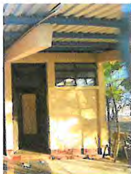
Foto 13: Pintura en muro exterior en los servicios sanitarios
