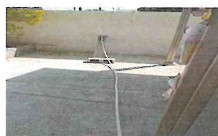
FOTO 6: Instalación de agua potable en patio
