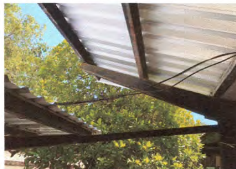
Foto 4: Instalación electrica desde el contador hasta la caja de filipon del salon de usos multiples
