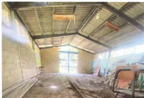
Foto 5: Pintura en muros interiores del salon de usos multiples
