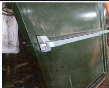
Foto 3: Chapa antipático con sistema de seguridad para apertura fácil de la puerta en caso de emergencia, la cual se considera una necesidad para resguardar la vida de las personas que se encuentren en peligro. Además se considera una inversión necesaria, fue seleccionada con el personal del establecimiento.
