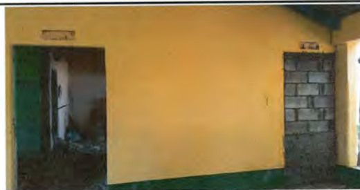
Foto 2: Renglones 23 y 24 repello y alisado en muro. Debido a la demolición de los baños que se encontraban anteriormente en el área, la paredes quedaron dañadas, por lo que se realizará repello y alisado con monocapa. Así también se realizará pintura por lo que estas fotografías hacen referencia al renglón 25.
