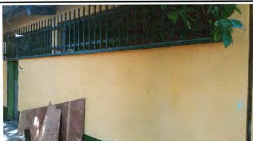
Foto 3: Renglones 23 y 24 repello y alisado en muro. Debido a la demolición de los baños que se encontraban anteriormente en el área, la paredes quedaron dañadas, por lo que se realizará repello y alisado con monocapa. Así también se realizará pintura por lo que estas fotografías hacen referencia al renglón 25.
