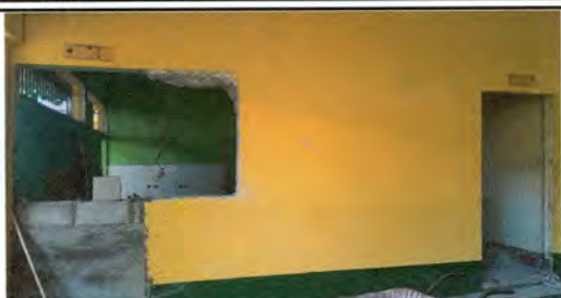
Foto 1: Renglones 23 y 24 repello y alisado en muro. Debido a la demolición de los baños que se encontraban anteriormente en el área, la paredes quedaron dañadas, por lo que se realizará repello y alisado con monocapa. Así también se realizará pintura por lo que estas fotografías hacen referencia al renglón 25.
