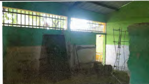
Foto 3: Renglones 23 y 24 repello y alisado en muro. Debido a la demolición de los baños que se encontraban anteriormente en el área, la paredes quedaron dañadas, por lo que se realizará repello y alisado con monocapa. Así también se realizará pintura por lo que estas fotografías hacen referencia al renglón 25.
