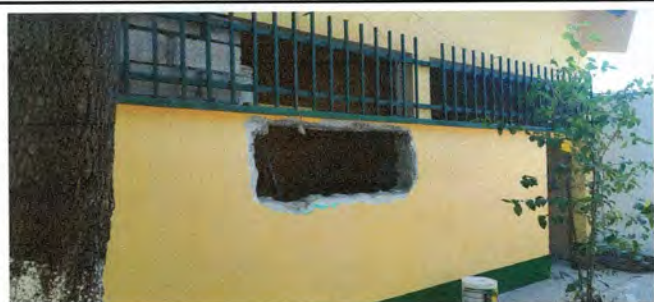
Foto 5: Renglones 23 y 24 repello y alisado en muro. Debido a la demolición de los baños que se encontraban anteriormente en el área, la paredes quedaron dañadas, por lo que se realizará repello y alisado con monocapa. Así también se realizará pintura por lo que estas fotografías hacen referencia al renglón 25.
