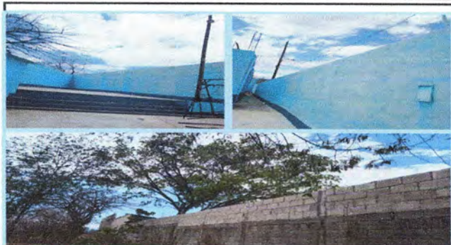
Foto 7: Suministro e instalación de alambre de pua y razor, Suministro e Instalación de tubo 1 1/4 para sostener malla y alambre razor (28 PIEZAS POR 0.50 DE ALTO) 125ML.
