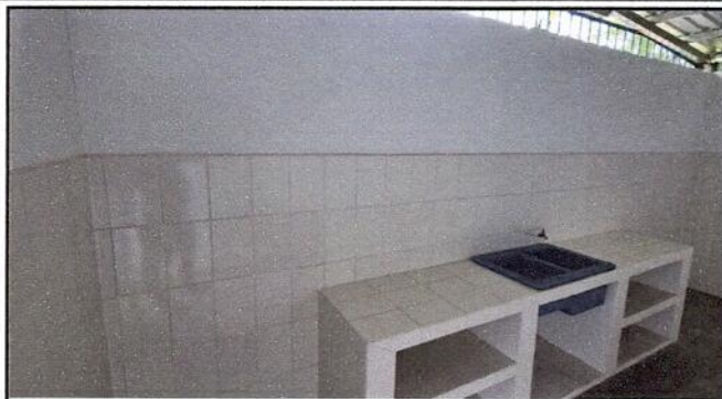
Foto 2: AREA PARA INATALACIÓN GABINETE AEREO.
