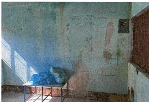
Foto 3. Sustitucion de repello y cernido en paredes por filtracion de agua pluvial
