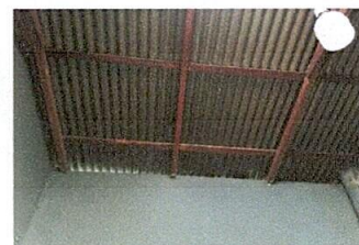
Foto 18: Sustrucion de maderapor costanera y lamina ondulada por troquelada
