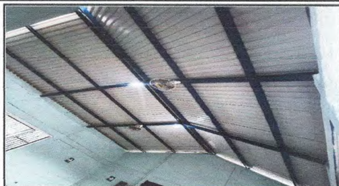
Numeral 3.6 y 3.7 Ventiladores Giratorios Para Cocina y Aula (2 en cocina, 1 extra en 1 aula) y sus instalaciones electricas para abastecimiento de energia.
