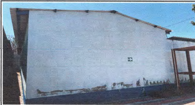
Numeral 1: Pintura en mal estado, (Aplicación de Impermabilizante, y Zocalo a una altura de 0.60m)
