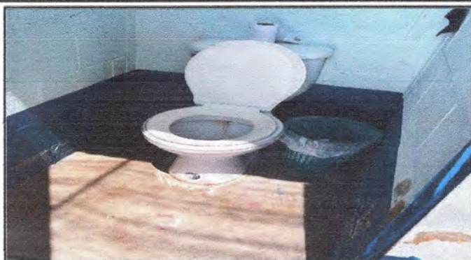
Numeral 4 (4.1) Inodoros en mal estado (Estan agrietados por la parte de atrás, se trataron de arreglar con porcelana pero no funciona, y estan mal instalados porque suelta demasiado mal olor y esta cerca de la cocina.
