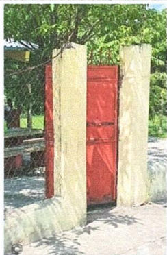
Foto 7: Sustrucción de puerta de metal en entrada principal de muro perimetral.
