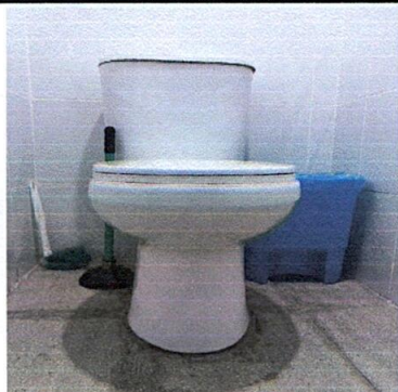
Modificacion de altura de sanitarios (El sanitario queda demasiado alto para los niños y no lo alcanzan, ya contamos con uno de altura reducida y los niños solo utilizan ese y aveces se satura, entonces por eso es la decicion de rebajarle a a la altura de los otros baños.
