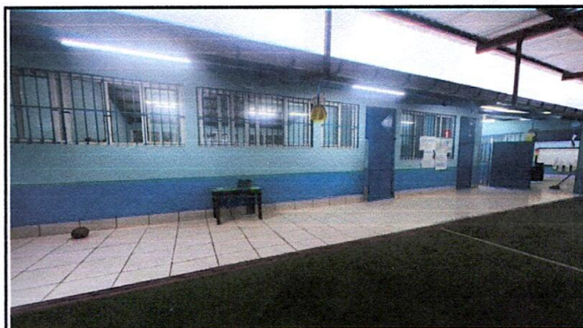
Mantenimiento a canales pluviales (Los canales estan en buen estado, lo que esta malo son los pescantes, y la inclinacion que este tiene, esto es lo que se va a remozar para darle solucion al problema, aparte del mantenimiento)
