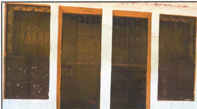
Numerales 1.4, 1.5 Ventanas y Balcones, Mantenimiento a Estructura (2 aulas, y cocina.
