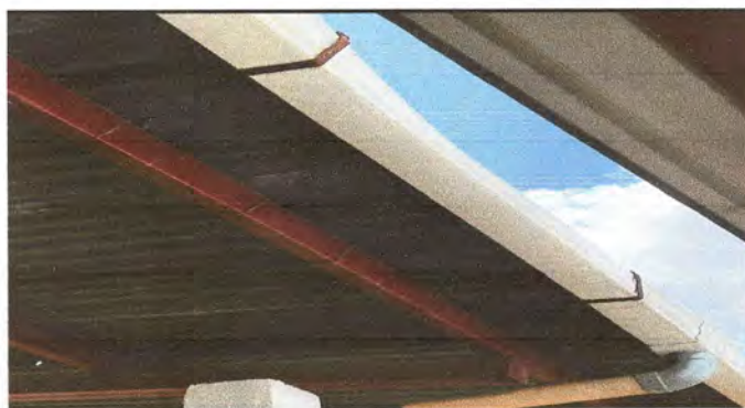
Numeral 6 Suministro e Instalacion de Canal de Lamina Lisa Aluzinc, Calibre 26 + Pescantes de Hierro (Como se puede observar, canal de pvc esta aguado y los pescantes estan oxidados)
