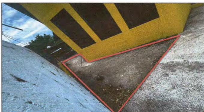
Numeral 3.1 Fundicion de Losa de Concreto a la par de salon de parvulos, se produce lodo (Lineas hacen referencia)
