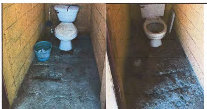
Numeral 2.2 Reparacion de Piso de Concreto (Se puede Observar el estado en el que se encuentran, se ven la armadura de losa) (Numeral 2.3 al reparar la losa de piso se colocara piso Ceramico)
