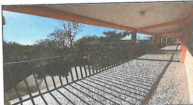
Foto 4: Evidencia de baranda en mal estado y area donde pega el sol a los salones
