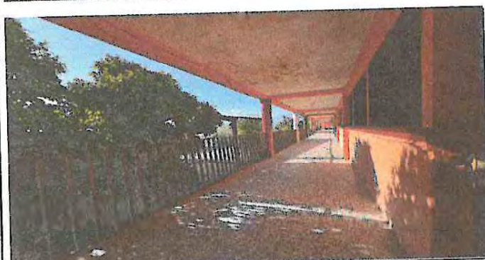
Foto 5: Evidencia de baranda en mal estado
