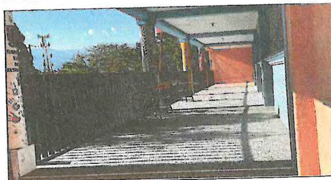
Foto 6: Evidencia de baranda en mal estado
