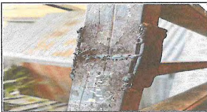
Foto 5: Partes quebradas y resoldadas
